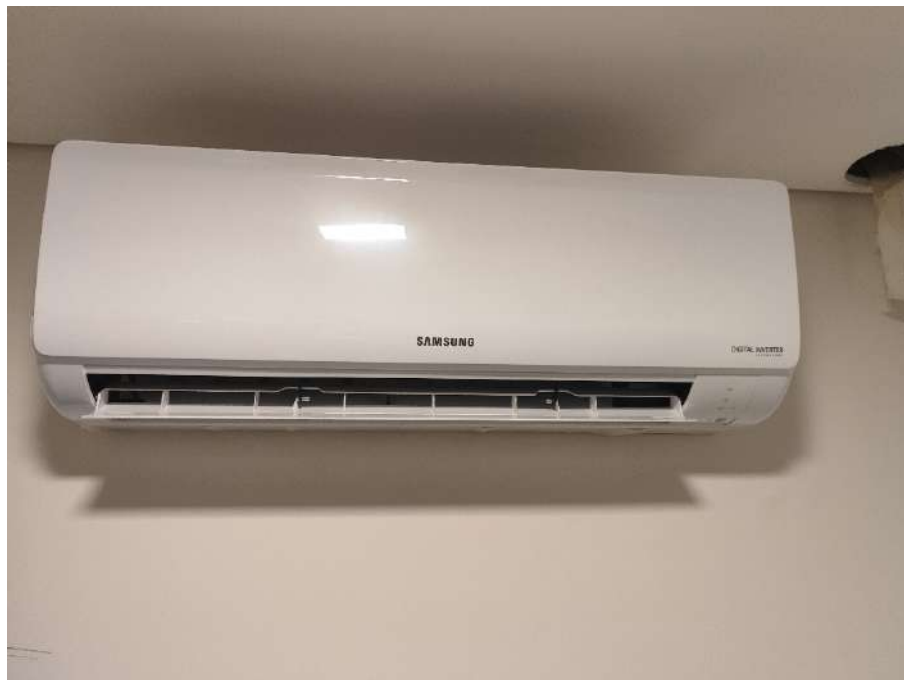
Fotografia 1 - Vista do aparelho de ar condicionado.
