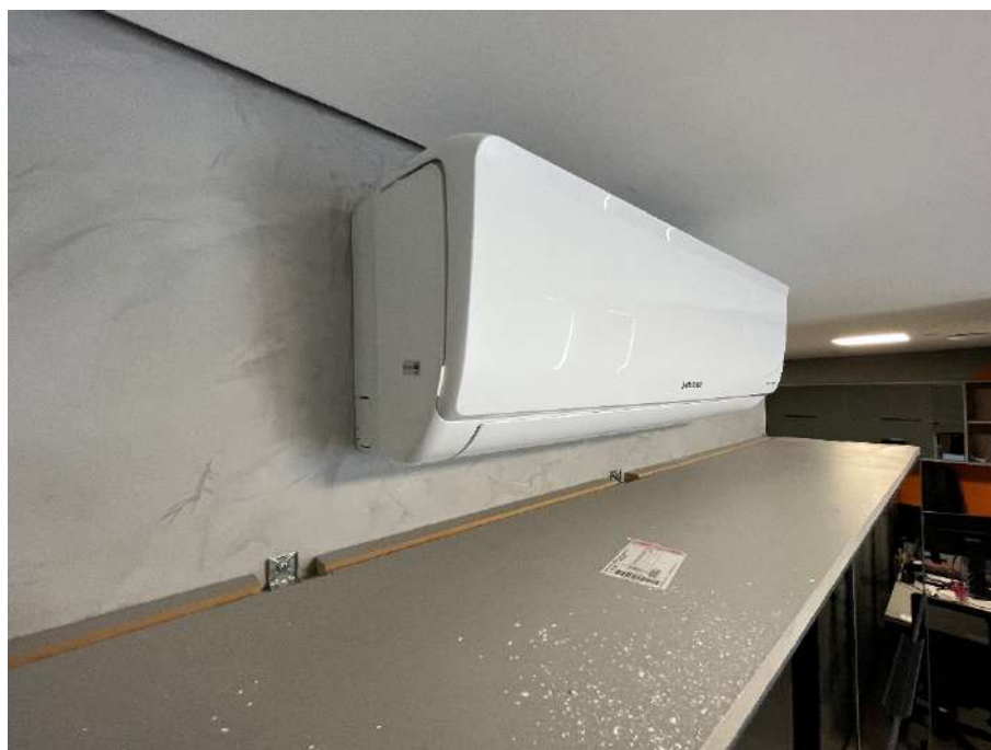
Fotografia 64 - Vista do aparelho de ar condicionado.
