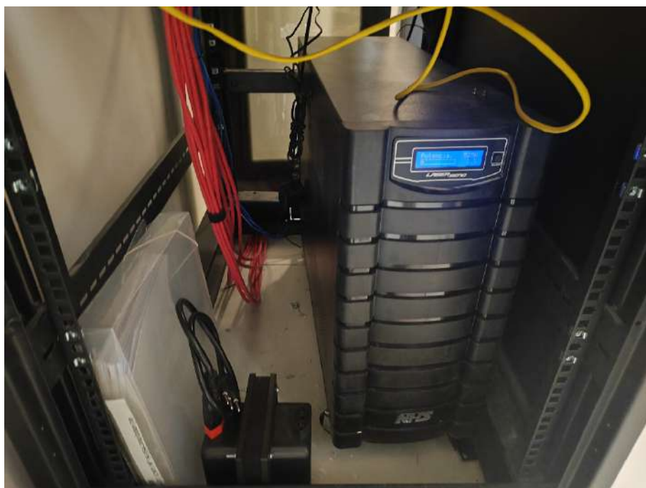
Fotografia 3 - Vista do nobreak
