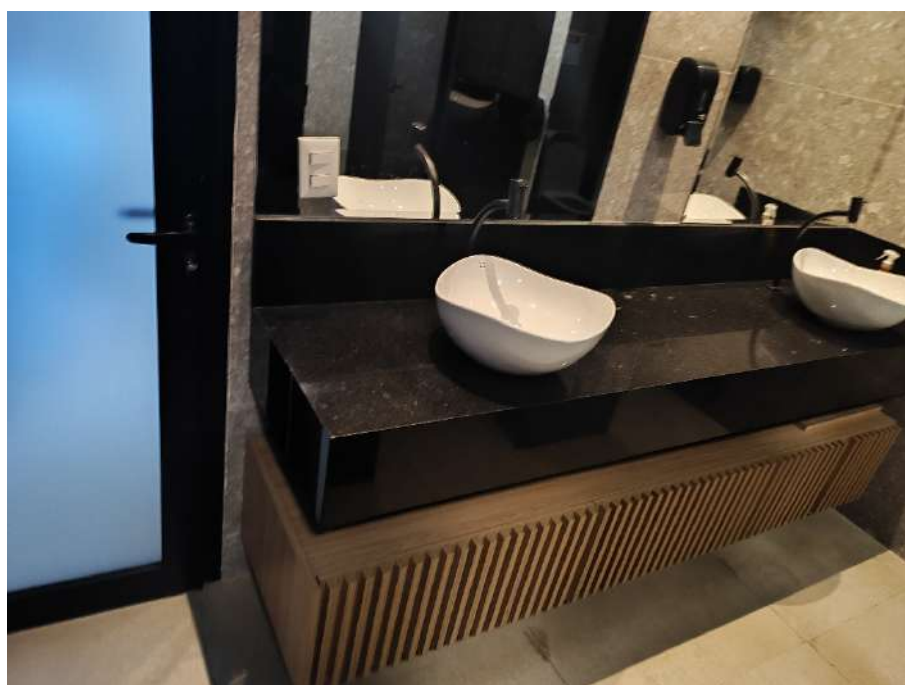
Fotografia 8 - Vista do banheiro - cubas da pia.
