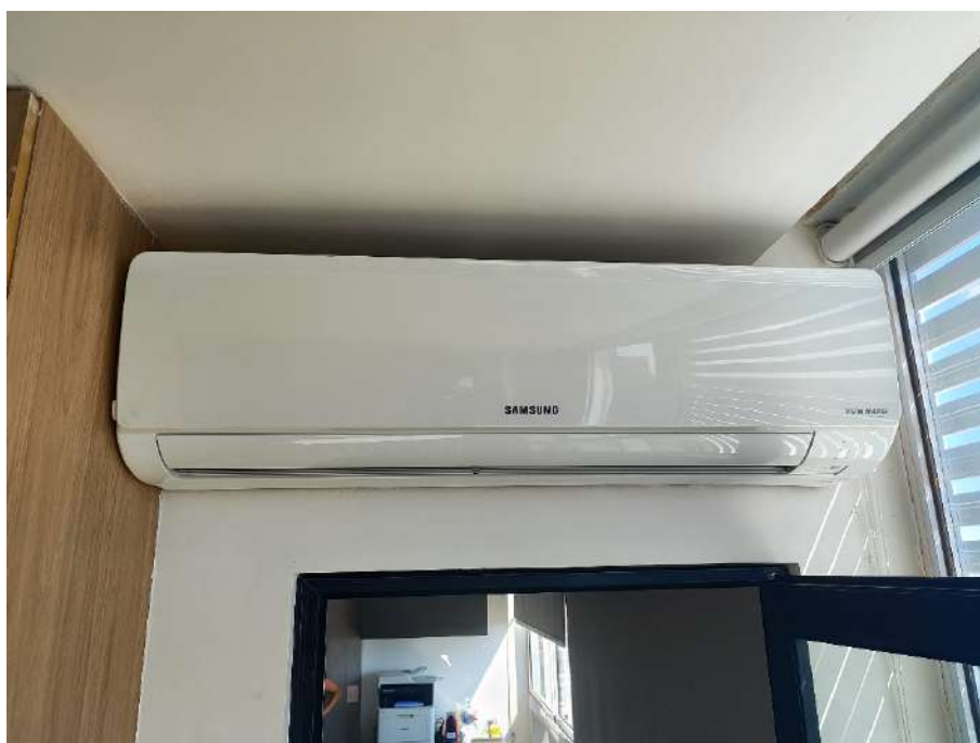
Fotografia 42 - Vista do aparelho de ar condicionado
