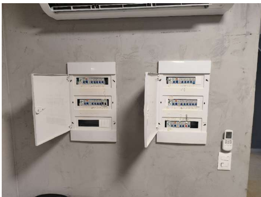
Fotografia 10 - Vista do quadro de força.
