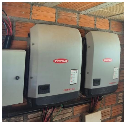
19. CONJUNTO FOTOVOLTAICO TRIFÁSICO
